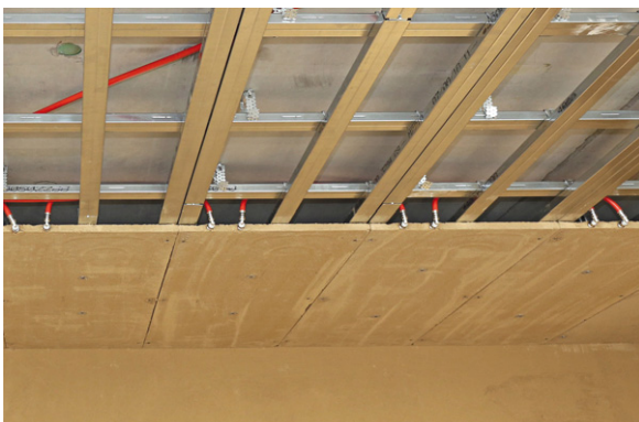
3 Klimaelemente zum Heizen und Kühlen an der Decke.
