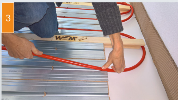
(3) Das Rohr wird in den Wärmeleitblechen verlegt und an den Heizkreisverteiler angeschlossen. Unter die Holzprofileleiste wird am Rand ein Korkstreifen gelegt.
